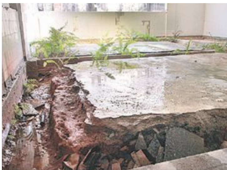
Colégio do bairro Roncador está afundando e pode causar desastre
