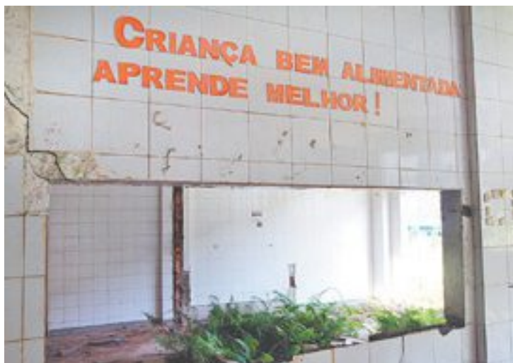
Mato e rachaduras no refeitório da Escola Darléia da Costa Maia
